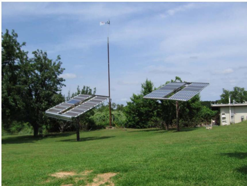
Paneles solares en el jardín.
